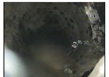
写真2 硬質ポリ塩化ビニル管（管径100mm 清掃後）
