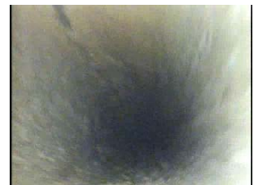
写真1 硬質ポリ塩化ビニル管（管径100mm 清掃前）
